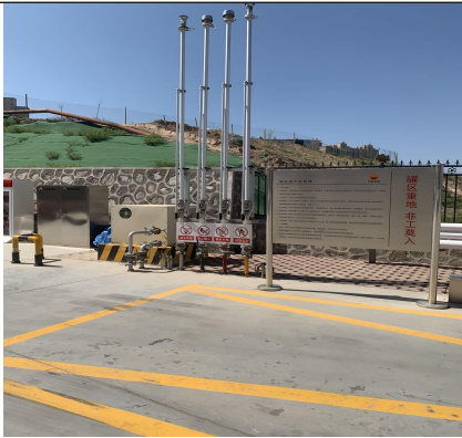
加油站呼吸管
