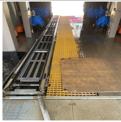
洗车隔油沉淀池
